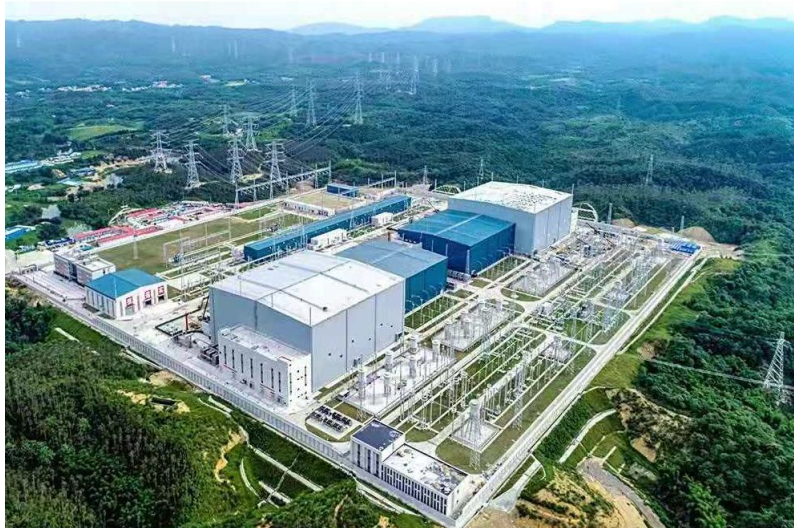
Station de conversion d'électricité en Chine
